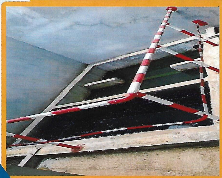
Décanteur d'eau usée
