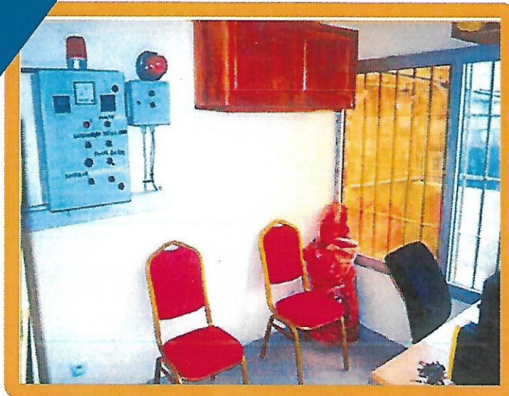
Armoire de commande automatique équipée des girophares signalant toutes anomalies dans le circuit
